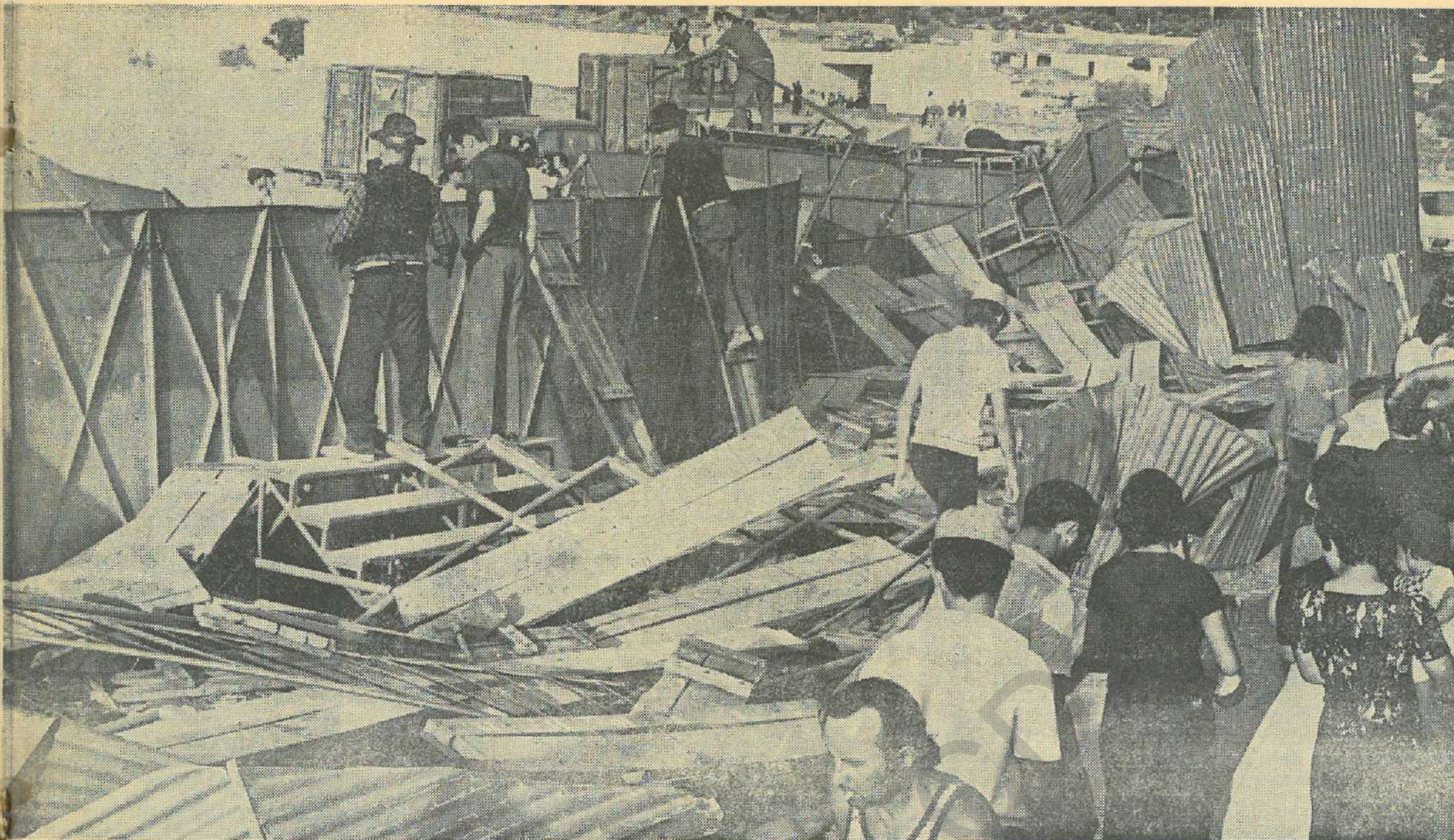
A estrutura metálica da Praça da Amareieja ruu em poucos segundos. Um pesado momento de confusão marcou a tragédia que custou a vida de três pessoas
